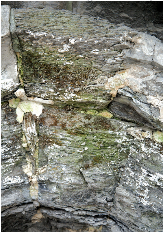
Fig. 6. Porte Mantile, détail d'un claveau au sommet de la voussure trilobée. Le mauvais état de conservation du cordon-larmier a entraîné le développement d'algues, de lichens et de mousses (© KIK-IRPA), Bruxelles, X057376.
