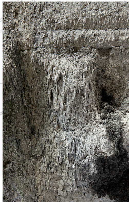
Fig. 4. Porte du Capitole, détail de la voussure trilobée. Le décor est totalement illisible suite à l'importante perte de matière provoquée par le délitage (© KIK-IRPA), Bruxelles, X057494.
