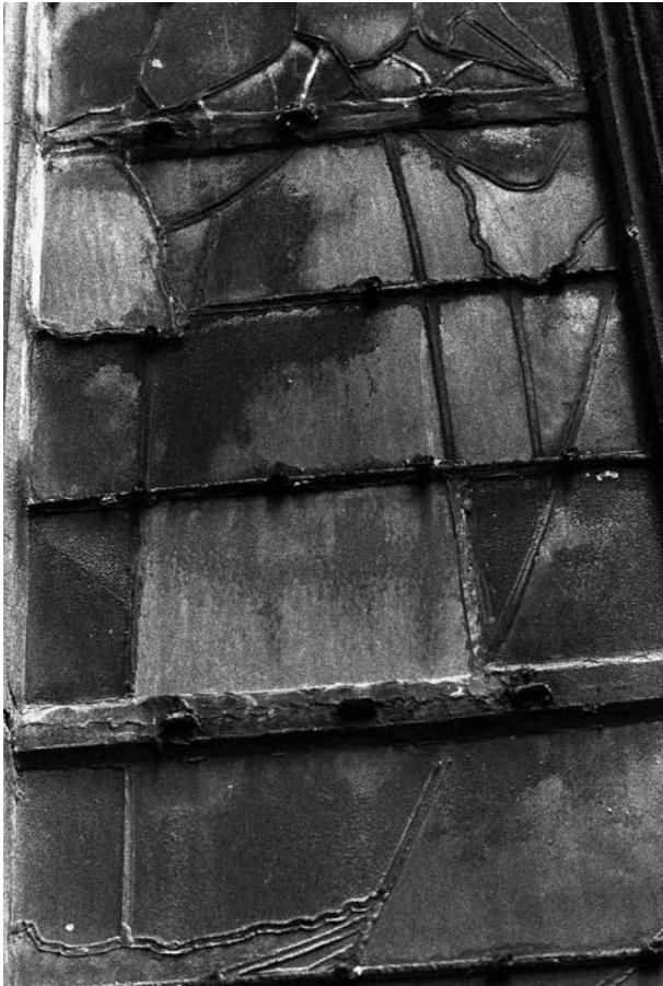
143. Observer la corrosion des vergettes, des feuillards et l'absence de clavette. Bemerk de corrosie van de bindroeden, van de losse bruggen en het ontbreken van de deugel.
