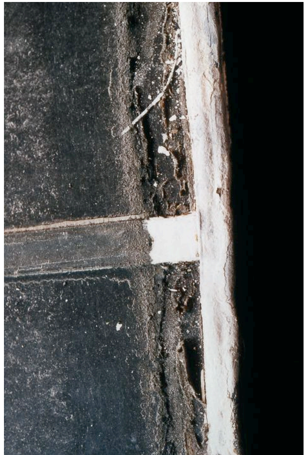
240. Verrière Sv1 de la chapelle Notre-Dame – panneau 17a. Corrosion du plomb de bord. Raam Zv1 van de Onze-Lieve-Vrouw-der-Bevrijdingskapel – paneel 17a. Aantasting randlood.
