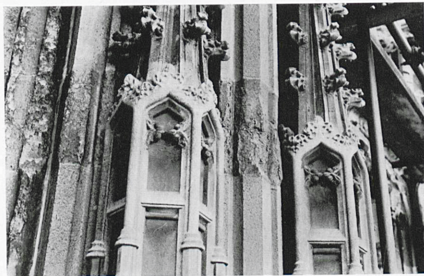
15. Restauration en pierre d'Euville. L'état du calcaire lédien maintenu lors de la restauration de 1900, comparé à celui de la pierre d'Euville introduite à la même époque, montre la rapidité avec laquelle cette pierre s'est dégradée en quelques dizaines d'années seulement.
