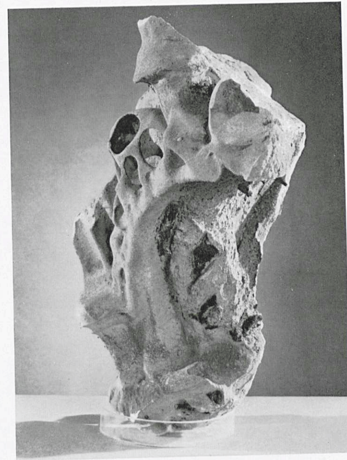
14. Pierre d'Avenes. Ornement provenant de la façade ouest montrant les effets de deux microclimats différents sur un même élément d'architecture : à gauche, délavage par la pluie; à droite, désagrégation par sulfatation.
