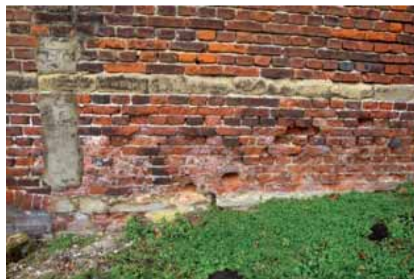
Afb.3 Gevel van een schuur gecontamineerd met kaliumnitraat. 00111920-0.
