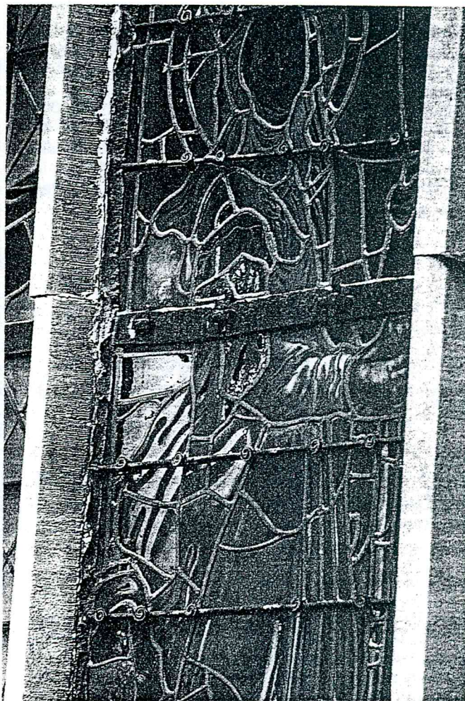
Fig. 22. Mons, collégiale Sainte-Waudru, détail du revers d'un vitrail (corrosion de l'armature métallique et altération des meneaux : observer les débordements de mastic qui subsistent en maints endroits et particulièrement aux deux registres supérieurs, ainsi que les interventions répétées particulièrement grossières entre le panneau et le meneau). Photo Isabelle Lecocq.
