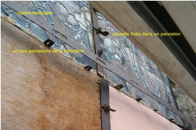
Fig. 31 : Armature ancienne d'un vitrail en cours de dépose, les panneaux déposés sont remplacés par une fermeture provisoire en bois. Chartres, baie du haut chœur. Photo I. Lecocq.
