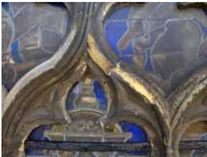
Fig. 32.- Dégradation du remplage de la baie NIV. © Architectes associés s.a., société civile d'architectes.
