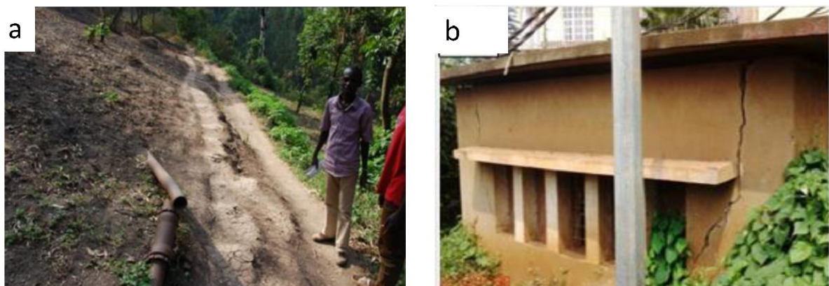
Figure 3: Exemples de dégâts sur les infrastructures. A: Rupture d'un tuyau de la RÉGIDESO au niveau du Lycée Wima (quartier Nkafu). B: Fissure d'une cabine de la SNEL à Nyawera (quartier Ndendere).
