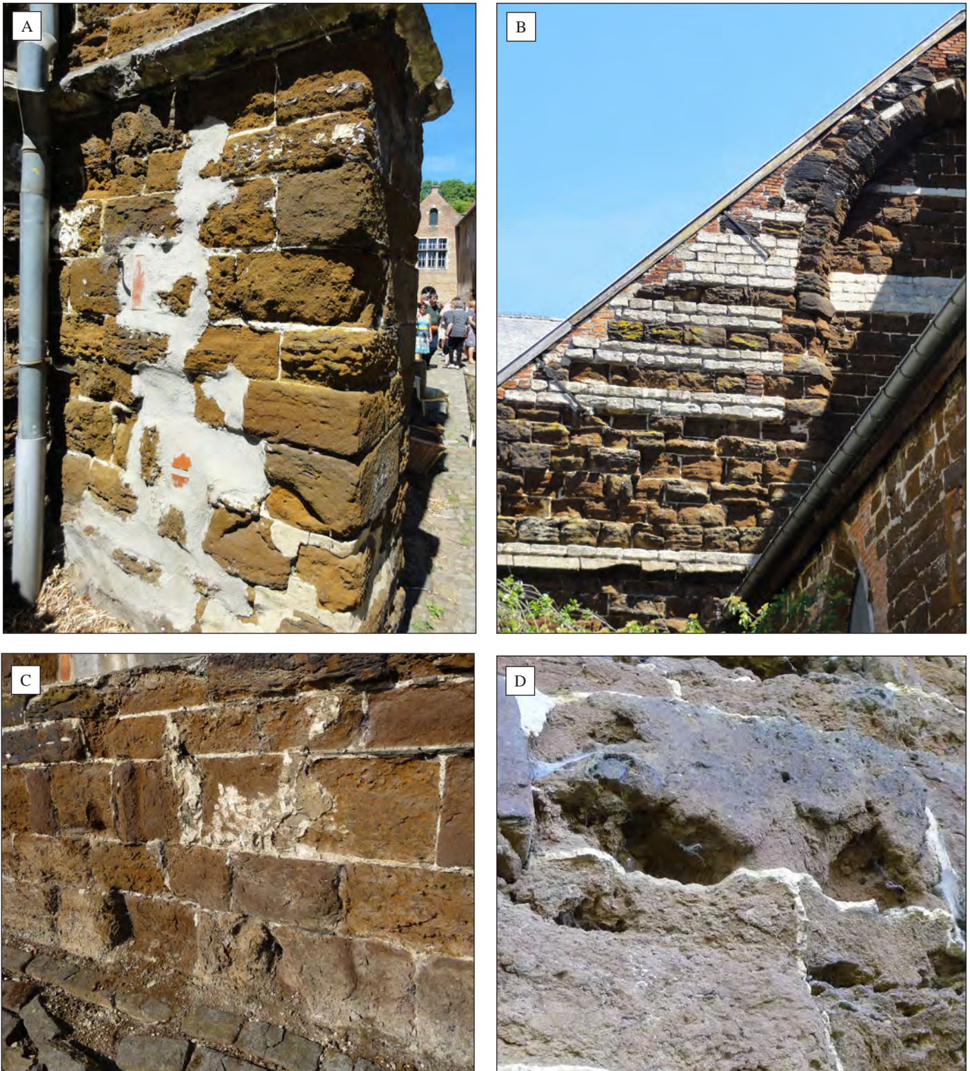
Figuur 7. Enkele voorbeelden van kenmerkende schadebeelden aan metselwerk in Diestiaan ijzerzandsteen. A. begijnhofkerk Sint-Catharina te Diest, B. Onze-Lieve-Vrouwekerk te Diest, C. Sint-Catharinakerk te Kortrijk-Dutsel en D. Maagdentoren te Zichem.
