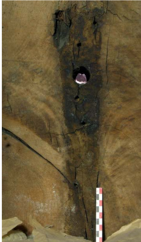
Fig. 3 – Détail d’une empreinte laissée par une armature en fer à la croisée d’un entrait et d’un poinçon dans la charpente de l’aile orientale – Rue Charles Buls (1.2) (Photo de travail ULiège/IRPA 2018 © SPRB).
