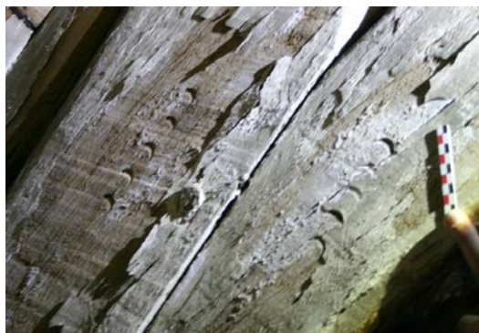
Fig. 2 – Détail d'une marque d'assemblage sur un aisseleur de la 5 e ferme de la charpente de l'aile classique (3.2) (Photo de travail ULiège/IRPA 2018 © SPRB).
