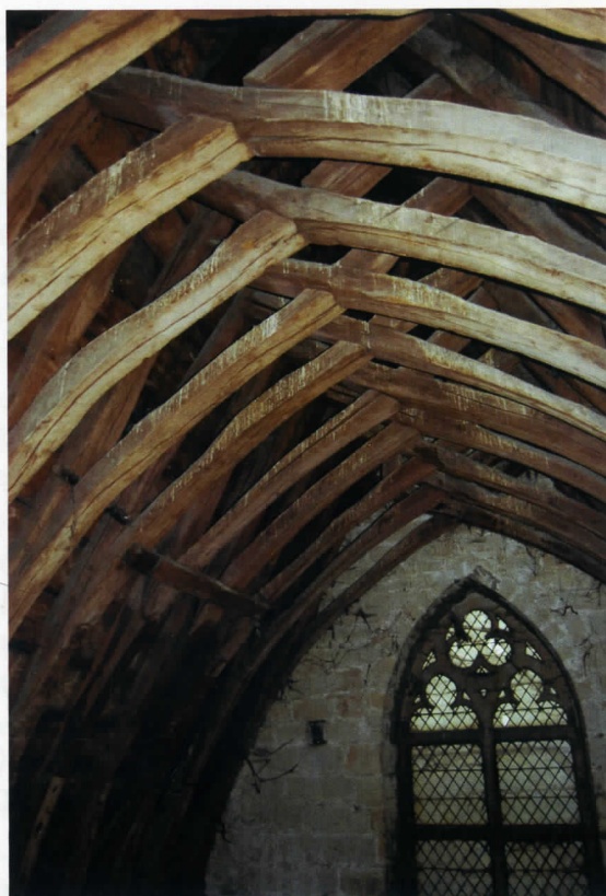
Fig. 2 : Charpente couvrant l'ancien porche, chapelle sud de la collégiale des Saints-Pierre-et-Guidon à Anderlecht © SPRB (photo : A. Weitz, 2016)
