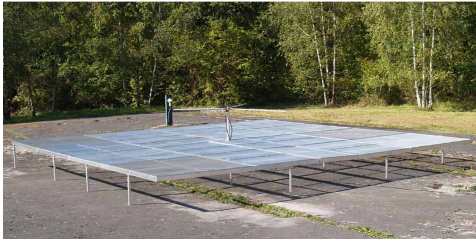
A gauche, l'antenne émettrice située à Dourbes (une antenne dipôle croisée avec une grille métallique de 8m sur 8m agissant comme plan réflecteur permettant de diriger les signaux radio plus efficacement dans l'atmosphère)
